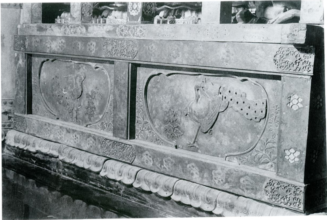
单色图3 同前南侧面（修理前）
