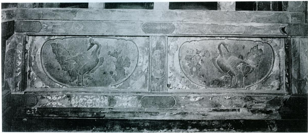
单色图8 同前側面（修理前）
